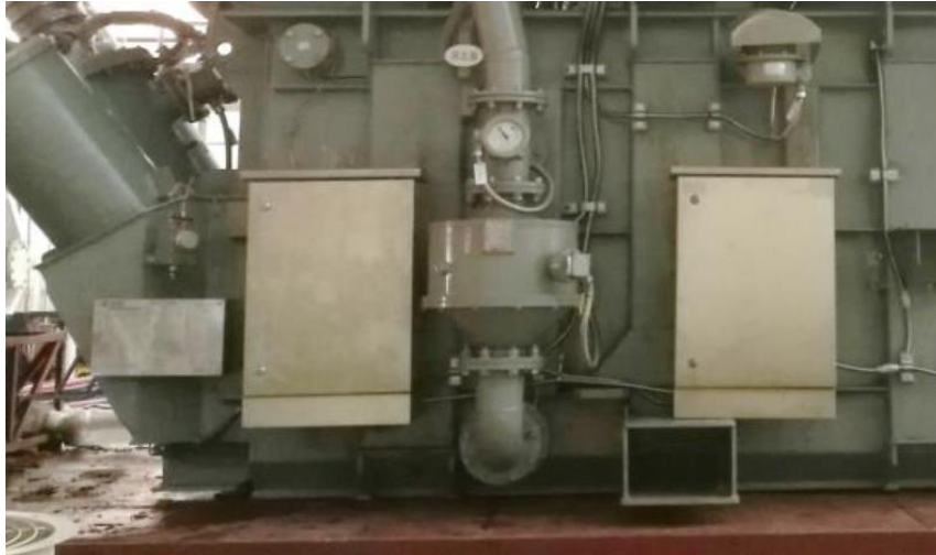
Шкафы системы на трансформаторе
