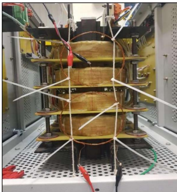
Измерительные катушки на трансформаторе
